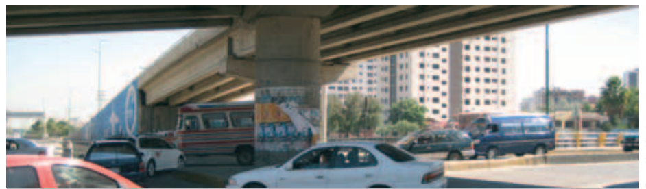
Paso a Desnivel en el Puente Muyurina de la ciudad de Cochabamba
