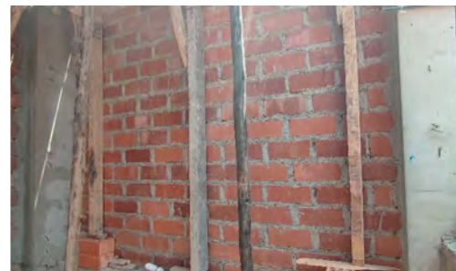
MP: Juntas del mortero mayor a 1,5 cm*
