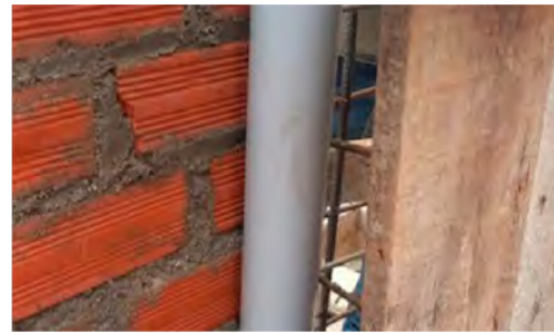
BP: Montante de 4" no atraviesa columna*
