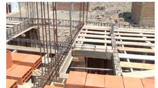
MP: Presencia de óxido en acero*
