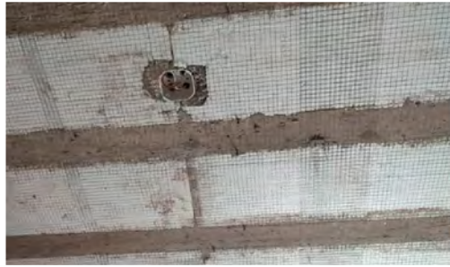
BP: Cajas no atraviesan las viguetas / uso de malla para que no se raje el tarrajeo*
