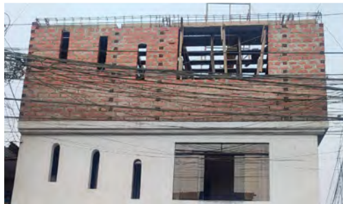
MP: Muros en alero no cuentan con columnas de amarre - Muros portantes con ladrillo pandereta*
