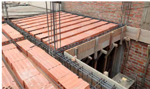
BP: Muros en alero no cuentan con columnas de amarre - Muros portantes con ladrillo pandereta*
