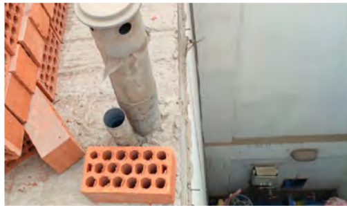
BP: Montante de 4" atraviesa muro de cabeza*
