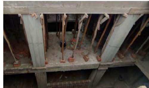
BP: Columnas, vigas sin cangrejeras*
