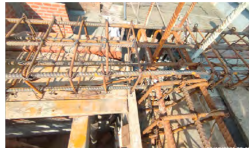
MP: Presencia de oxido en acero / insuficiente longitud de desarrollo de las vigas*
