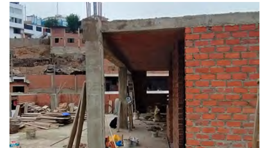
BP: Tubo de 2" en falsa columna / No hay cangrejeras en columnas*
