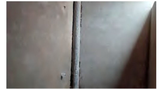
MP: Montante de 4" no atraviesa muro portantes ni vigas*
