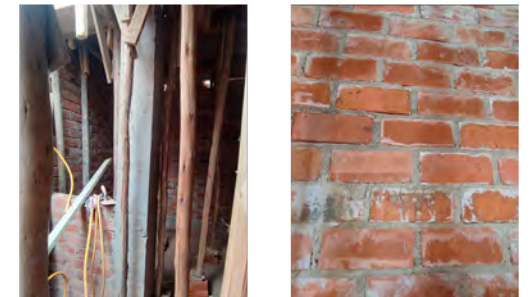
BP: Columnas sin cangrejeras / espesor del mortero de 1,5 a 2 cm*
