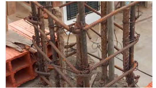
MP: Incorrecta longitud de empalme en columnas*
