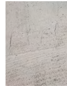
MP: Fisuras en los aligerada (concreto magueado)*
