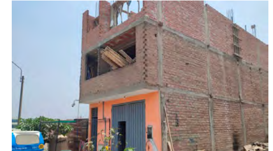
MP: Muro de fachada sin amarre*
