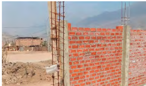
MP: Presencia de óxido en acero*
