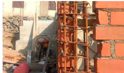
MP: Presencia de óxido en acero de columnas*
