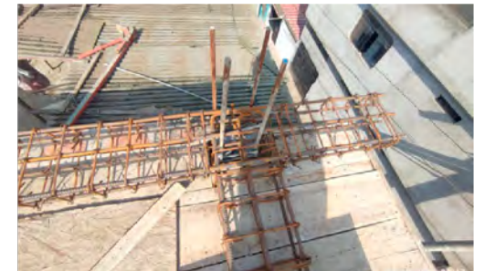
MP: Insuficiente longitud de empalme para traslape de columnas*
