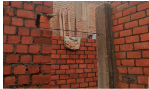
BP: Dintel con acero insuficiente*
