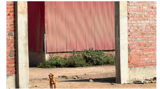
BP: Ausencia de cangrejeras en columnas*
