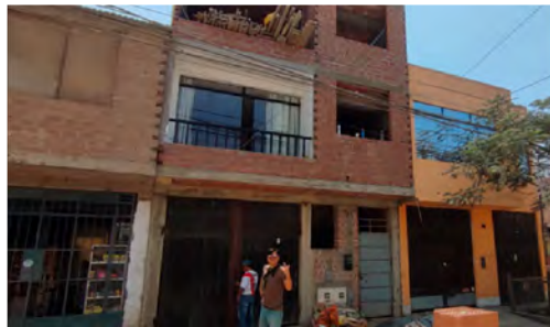
MP: M uros de fachada sin amarre*
