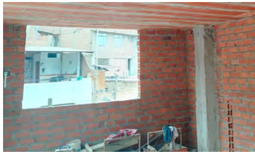
MP: Falta de columnetas de amarre en muros (aleros)*
