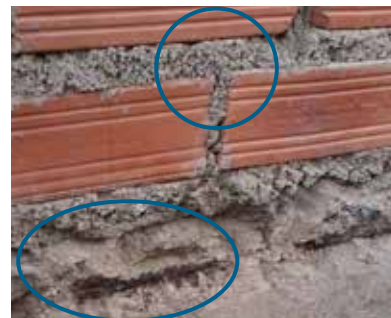
EXCESIVO ESPESOR DE JUNTA DE MORTERO - ACERO EXPUESTO
