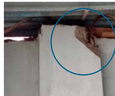
MUROS SIN VIGAS SOLERAS - ACERO EN PROCESO DE OXIDACIÓN
