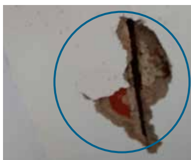
DESPRENDIMIENTO DEL CONCRETO - ACERO DE REFUERZO EXPUESTO
