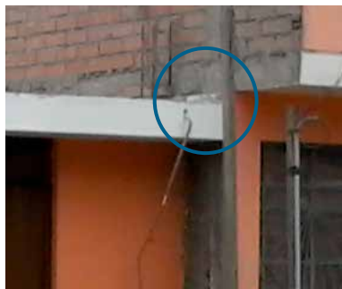
AUSENCIA DE JUNTA SÍSMICA Y LOSAS A DESNIVEL
