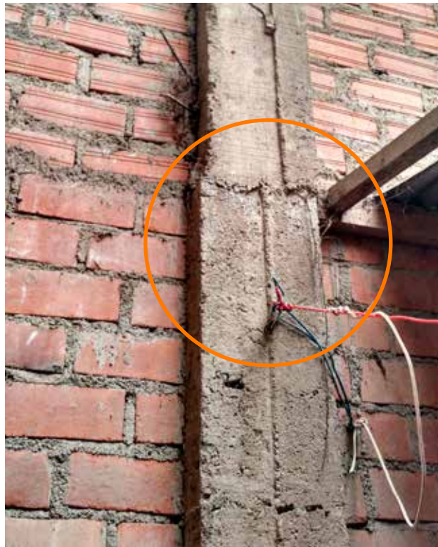
Ilustración N° 1 Muro de doble altura sin viga intermedia de amarre
