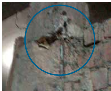
UNIÓN INADECUADA SIN ADITIVO EPÓXICO
