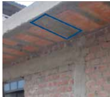
VOLADIZOS EXCESIVOS (80 CM APRX)
