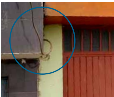
AUSENCIA DE JUNTA SÍSMICA Y LOSAS A DESNIVEL (POSIBLE CHOQUE)
