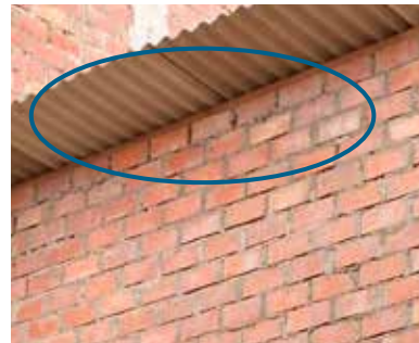
MUROS PORTANTES SIN CONFINAR
