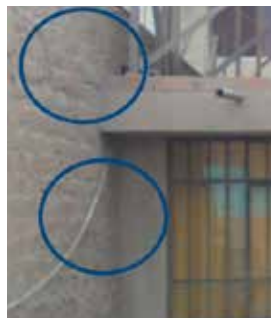
AUSENCIA DE JUNTA SÍSMICA Y LOSAS A DESNIVEL
