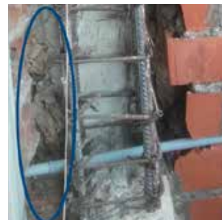
COLUMNA SIN CONFINAMIENTO CORRECTO
