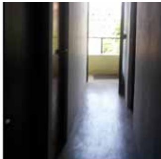
FALTA DE ILUMINACIÓN Y VENTILACIÓN EN LA SEGUNDA PLANTA
