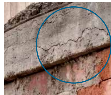
VIGA AGRIETADA - MURO SIN ADECUADO CONFINAMIENTO
