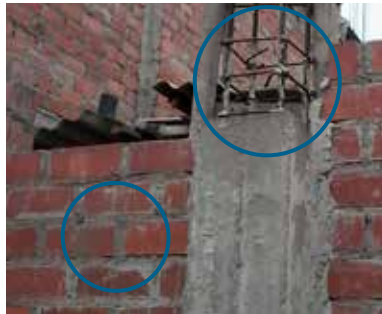
ACERO EXPUESTO - ESPESOR IRREGULAR DE JUNTAS DE MORTER
