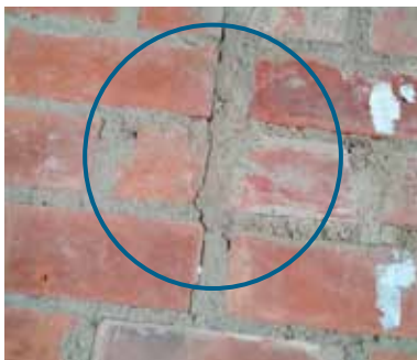
INCORRECTA SUPERPOSICIÓN DE LADRILLOS
