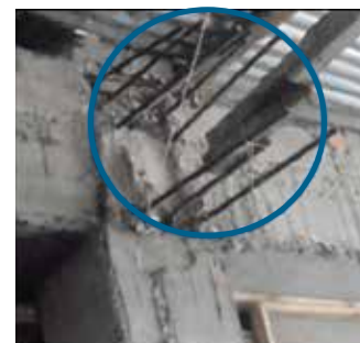
ACERO DE REFUERZO EXPUESTO
