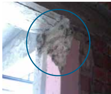
COLUMNAS MAL VACIADAS
