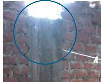
MUROS PORTANTES DE LADRILLO INADECUADO Y SIN CONFINAMIENTO
