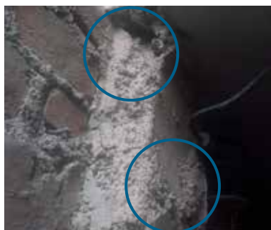
DEFICIENTE UNIÓN ESTRUCTURAL - ACERO EN PROCESO DE OXIDACIÓN
