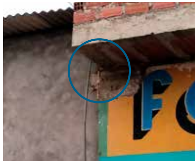
AUSENCIA DE JUNTA SÍSMICA Y LOSAS A DESNIVEL (POSIBLE CHOQUE)
