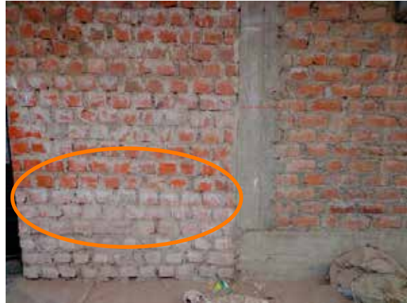
Ausencia de cemento y sobrecimiento.
