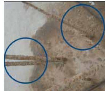
ACERO DE REFUERZO EXPUESTO
