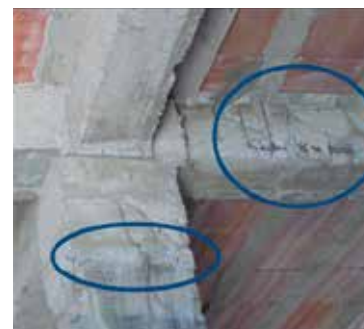
JUNTA FRÍA - ACERO EN PROCESO DE OXIDACIÓN
