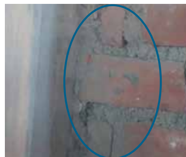
MURO PORTANTE FISURADO
