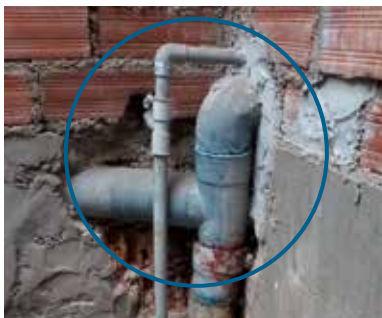
TUBERÍAS DE AGUA Y DESAGUE EXPUESTAS, Y MUY JUNTAS
