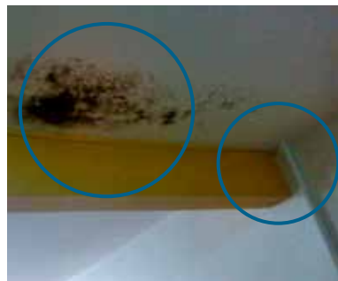
HUMEDAD EN LOSA Y INADECUADA CONEXIÓN VIGA-COLUMNA
