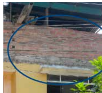
TABIQUERÍA SIN COLUMNETAS
