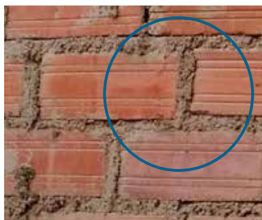
INADECUADO ESPESOR DE JUNTA DE MORTERO (APRX 4 CM)
