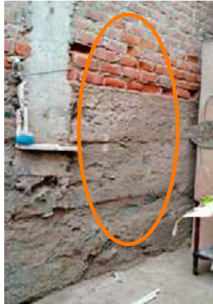
Sobrecimientos afectados por las sales, disgregando los componentes del concreto y afectando también a los ladrillos.
