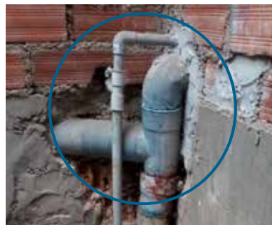
TUBERÍAS DE AGUA Y DESAGÜE EXPUESTAS Y MUY JUNTAS
