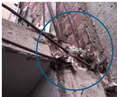
ACERO EN PROCESO DE OXIDACIÓN
