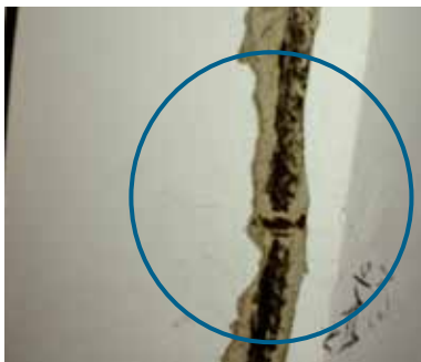
ACERO DE REFUERZO EXPUESTO - DESPRENDIMIENTO DE CONCRETO
