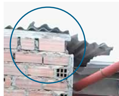
MUROS PORTANTES SIN CONFINAR - JUNTAS DE MORTERO SIN FRAGUAR
