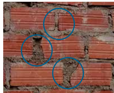
JUNTAS DE MORTERO SIN FRAGUAR
