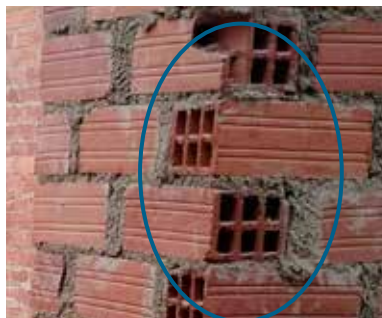
MURO PERPENDICULAR SIN AMARRAR
