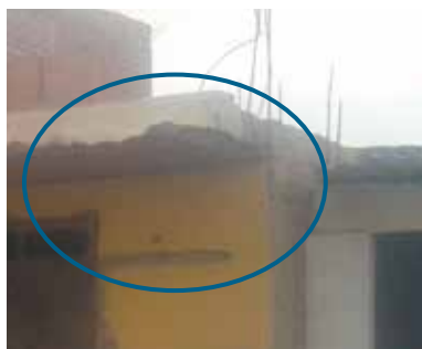
CORROSIÓN DE ACERO - AUSENCIA DE JUNTA SÍSMICA
