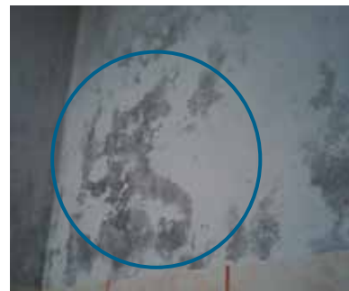
HUMEDAD EN MUROS Y LOSAS
