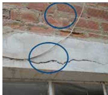
JUNTA DE MORTERO INADECUADA Y VIGA AGRIETADA
