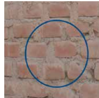
ESPESOR EXCESIVO DE JUNTAS DE MORTERO
