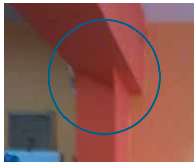
DEFICIENTE UNIÓN ESTRUCTURAL VIGA - COLUMNA
