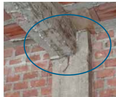
MALA CONEXIÓN VIGA COLUMNA
