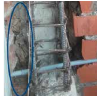
COLUMNA SIN CONFINAMIENTO CORRECTO
