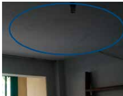
HUMEDAD EN LOSA ALIGERADA
