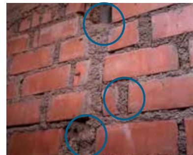
TUBERÍA INMERSA EN MURO SIN CONTINUIDAD - EXCESIVO ESPESOR DE JUNTA DE MORTERO
