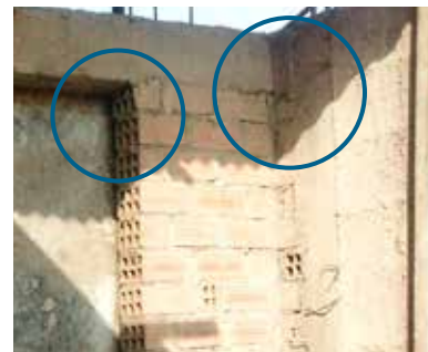
LADRILLO INADECUADO Y DEFICIENTE CONEXIÓN VIGA-COLUMNA
