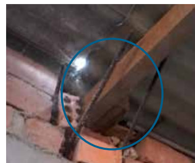
MURO PORTANTE SIN CONFINAR - EXPOSICIÓN DE ACERO
