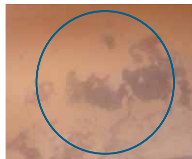
EFLORESCENCIA EN MUROS
