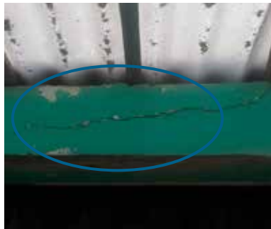
FISURAS EN LOSA ALIGERADA
