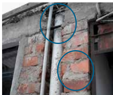
TUBERÍA INMERSA EN MURO Y VIGA - MURO NO TIENE CONTINUIDAD CON MECHAS DE ACERO
