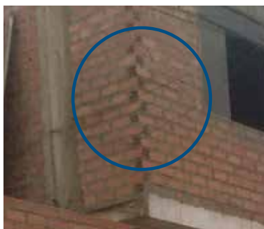
MUROS PORTANTES SIN ADECUADO CONFINAMIENTO
